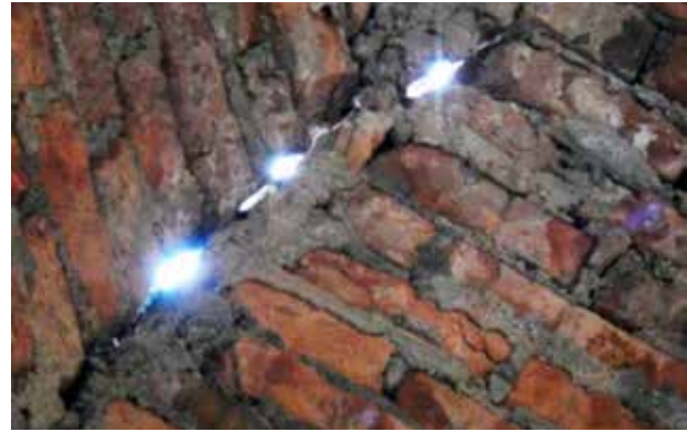
Figura 11. Fisuras en casquetes de la cúpula del Templo Santa Lucía Fuente: fotografía de los autores.
