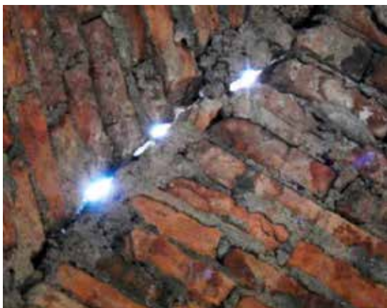
Figura 11. Fissuras em calotas da cúpula do Templo Santa Lucía Fonte: fotografia dos autores.
